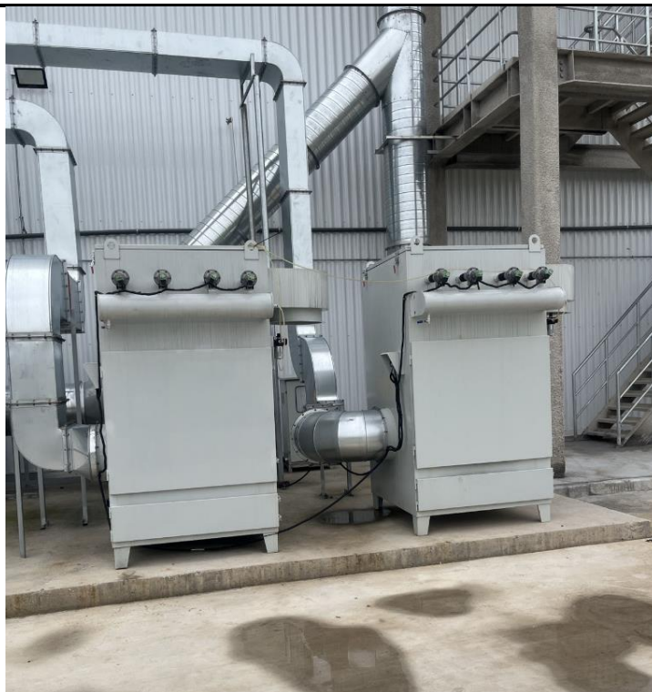
图 3-2 滤筒除尘装置
